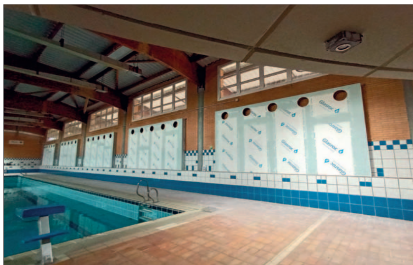
INSTALACIONES. Una de las mejoras instaladas en la piscina de cara a esta nueva temporada.
